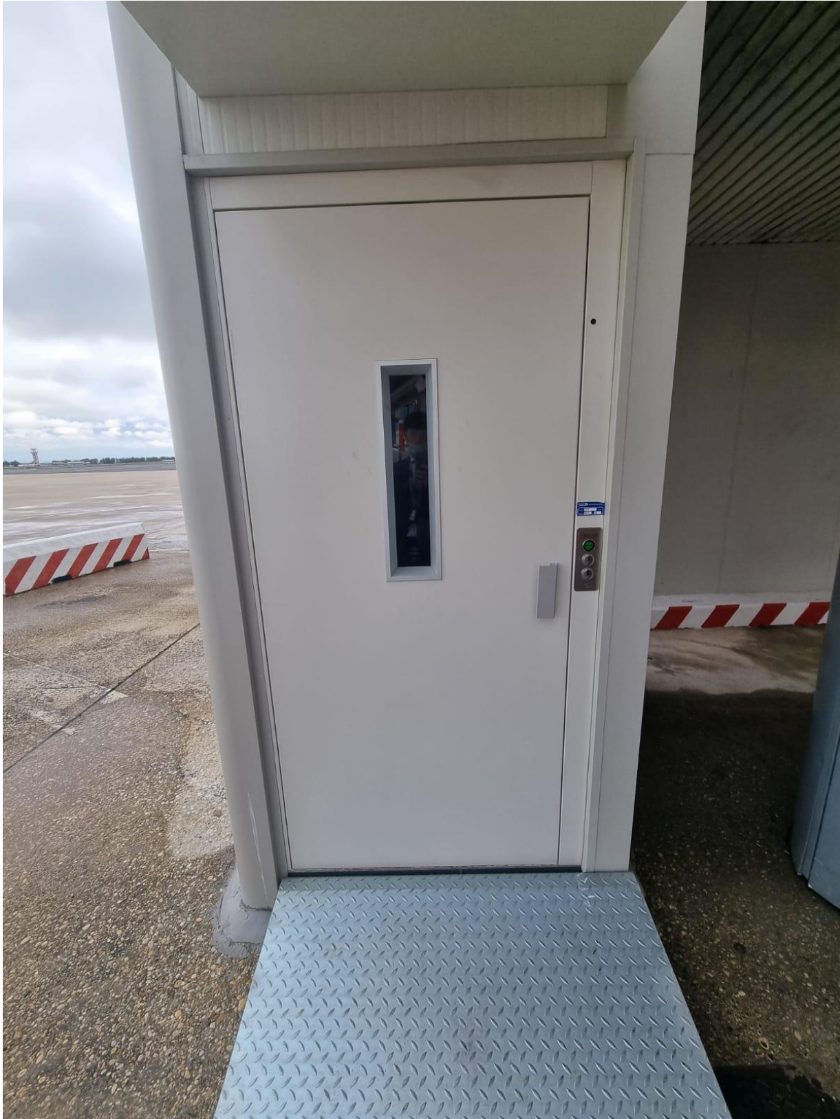
Immagine 2. Montacarichi, quota pista
